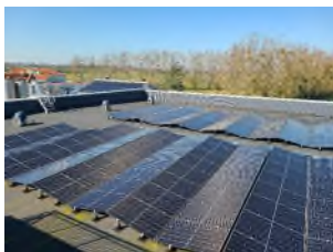
Figure 30 : Centrale Photovoltaïque de Chef-du-Pont
